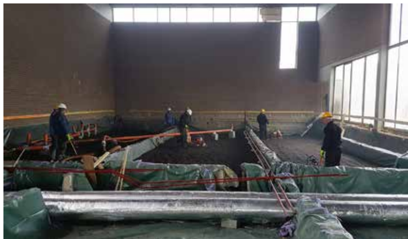
De Sint-Jozef Arbeiderkerk tijdens de werken: op de foto zijn de leidingen voor het ventilatiesysteem en de isolatie met kleikorrels goed zichtbaar (foto Monument GoedLeven)
