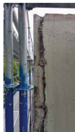
Barsten in de hoeken waar twee ringbalken samenkomen, 2019 (foto Monument Goedleven, Jellis De Bruyn)
